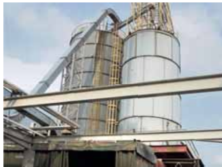
สายพานลำเลียงจากตู้กรองไปยังไซโล
