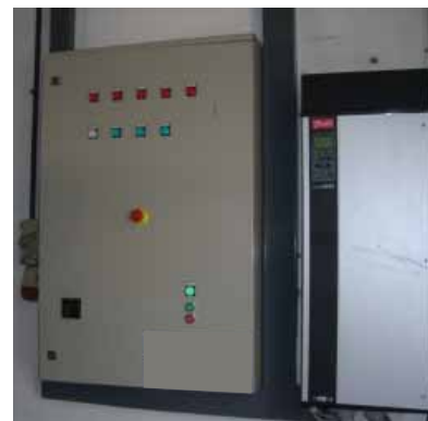
ตัวอย่าง: แผงควบคุมที่ติดตั้งกับผนัง
