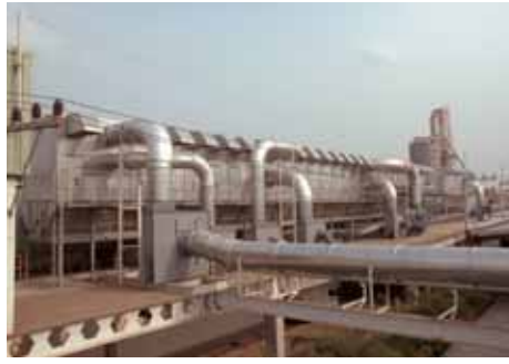
ตู้ NFK ที่ติดตั้งบนหลังคาโดย
