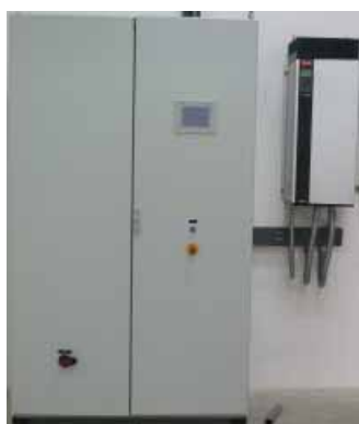
ตัวอย่าง: แผงควบคุมที่ติดตั้งที่พื้น
